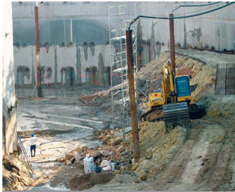
Obres de perforació a Can Gili Vell. Una fisura en el mur pantalla de la obra de perforació del pàrquing va ocasionar esquerdes al paviment del carrer i en els edificis propers a l'obra.
