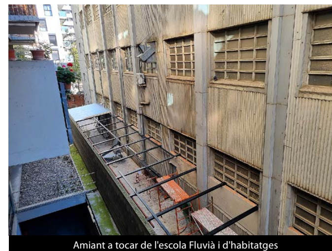
Amiant a tocar de l'escola Fluvià i d'habitatges
