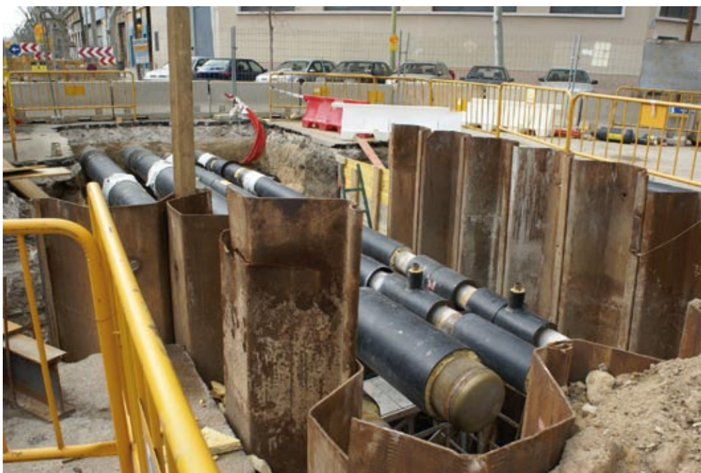
Les obres del Pla d'Infraestructures que consisteixen en soterrar les conduccions de la climatització centralitzada són les responsables de les esquerdes aparegudes en múltiples finques al carrer de Granada.
