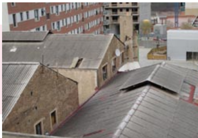
Estat actual de les cobertes de l'edifici de la cooperativa Pau i Justícia
