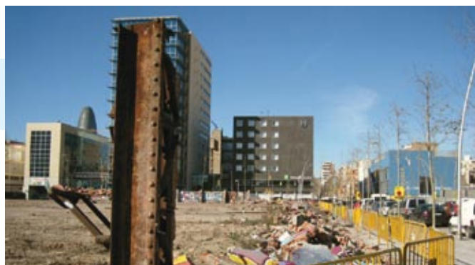
Solar on va ocórrer l'accident. El mur que es va desplomar ocasionant l'accident va ser immediatament enderrocat pels bombers.
