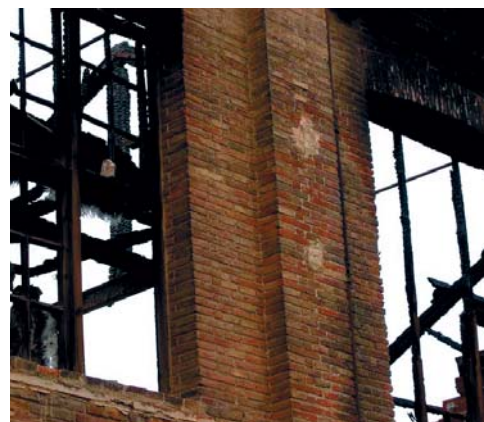
fàbrica de Ca l'Alier, al carrer de Flavià-Pere IV. El dia 29 de novembre es va calar foc a quarts de dotze de la nit. No hi havia ningú a la fàbrica a excepció d'un vigilant pagat pel propietari de les naus.
